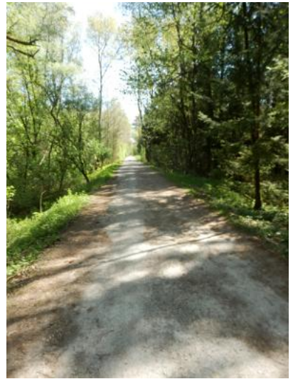
Die Grundlose Straße wurde immer wieder durch Austrocknung des Untergrundes geschädigt
