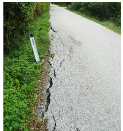
Durch die heurige Hitzewelle waren die Schäden arg
